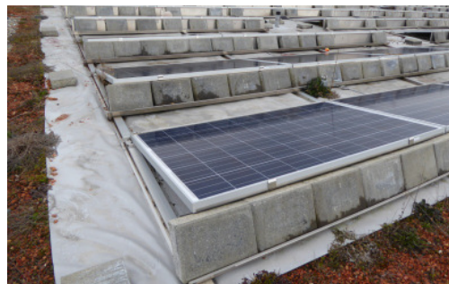
Bild 4: Ungeeignetes Befestigungssystem. Die Fläche unter der Anlage ist nicht zugänglich und wurde deshalb teilweise mit einer Folie abgedeckt. So sieht keine gute Lösung aus.
